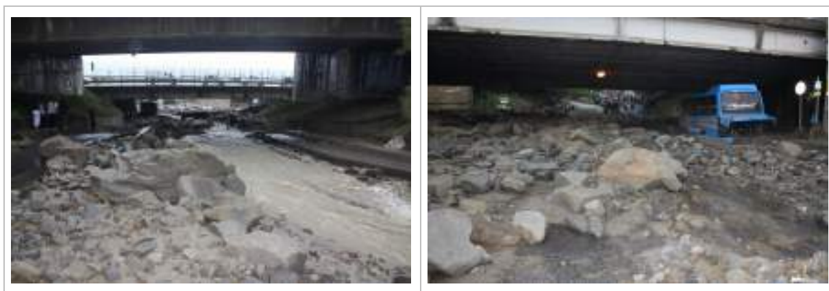
Figura 7.47 – Impatti dell'evento di settembre 2009 all'altezza dell'attraversamento della SS 114 sul torrente Sillemi nel Comune di Letojanni (ME) – Fonte: Ufficio Tecnico Comune di Letojanni.
